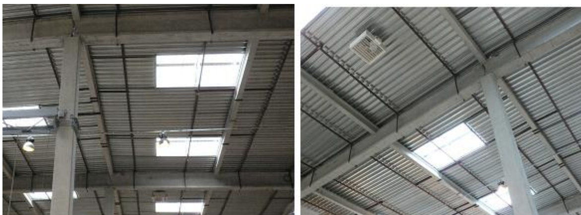
Figure 12 : Dispositifs d'évacuation naturelle des fumées et des chaleurs (DENFC)
